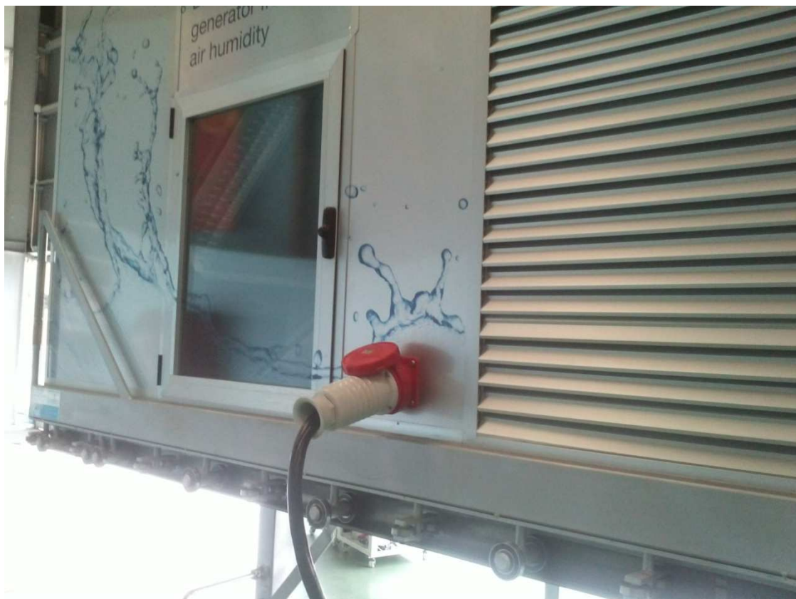
Toma de corriente
